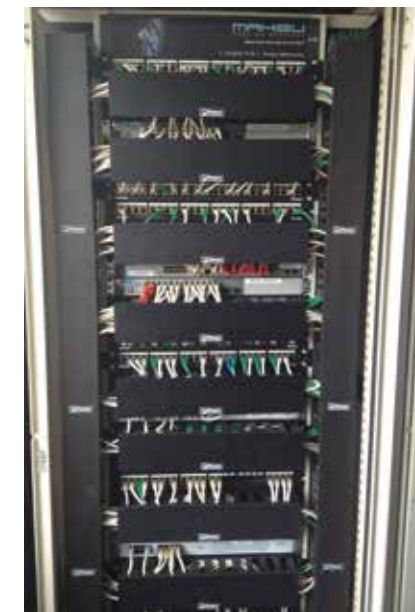
De standaarden voor databekabeling evolueren razendsnel. Mahieu Cabling Services volgt ze op de voet.
